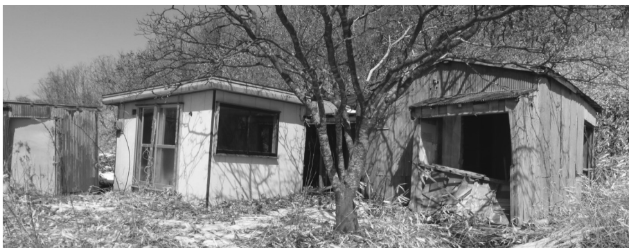
次第に崩れ行く放置された空き家
