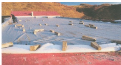
被災した屋上は、コンクリート製の重しによって、一時的に復旧している
