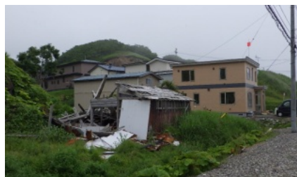
強風による飛散が心配される空き家
