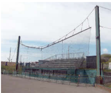
暴風で被災した町営野球場バックネット
