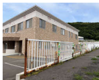
腐食が進む国保診療所の外周柵
